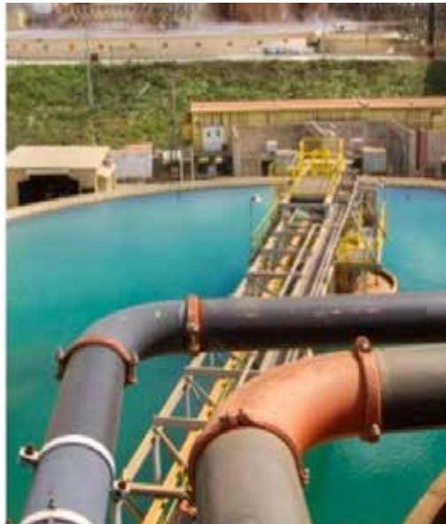
Figura 20. Planta de tratamiento de aguas del proceso productivo de Barrick PVDC
